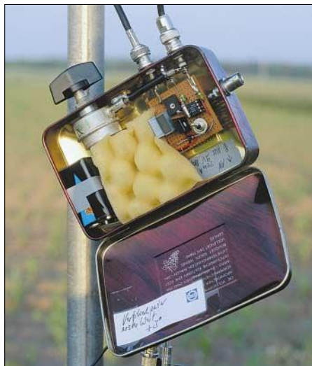
Bild 6: Innenansicht der Umschaltbox mit der Schaltung gemäß Bild 4
